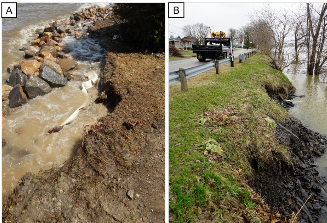
Figure 68. (A) Érosion par surverse pendant les inondations de 2019 derrière un enrochement mis en place à la suite des événements de 2017, lequel protège un terrain de remblai dans la municipalité de Pointe-Fortune. (B) Érosion par affouillement d'un remblai au printemps 2019 sur une route de l'île Saint-Ignace.
